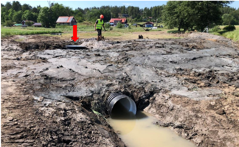
Figur 9. Regleringsmunken med utloppsrör synligt. Vid den röda pilen syns locket till stigröret där sättrar placeras i för att dämna våtmarken. Foto: Rickard Gustafsson.
