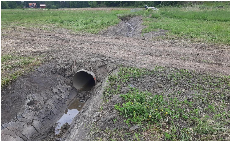
Figur 7. För att möjliggöra etablering av maskiner för framtida skötsel av våtmarken placerades vägtrummor i den nya bäckfåran. På bild visas en av de två vägtrumorna. Foto: Erik Johansson.
