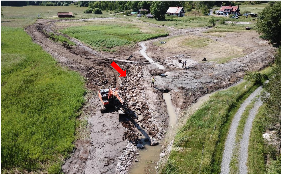
Figur 11. För att möjliggöra vandring för fiskar och andra vattenlevande organismer anlades en faunapassage i form av ett omlöp i anslutning till regleringsmunken. Foto: Rickard Gustafsson.
