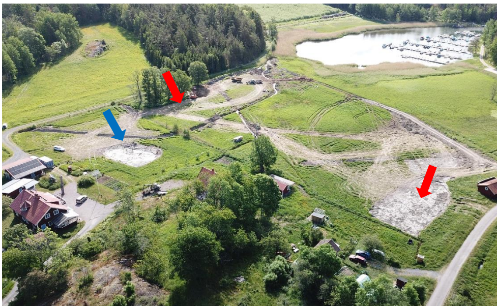
Figur 4. Massor för byggnation av dammvall togs från en damm (blå pil) som skapades norr om området samt områden med högre marknivåer inom våtmarken (röda pilar). Foto: Rickard Gustafsson.
